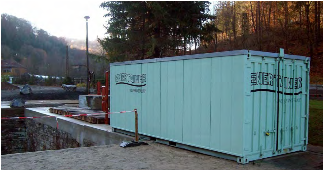
Bild: ENERTAINER®-Wasserkraftanlage in Rübeland / Harz
